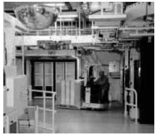
Figura 6: A questo incrocio è possibile vedere nello specchio se il passaggio è libero. Gli sbarramenti proteggono le persone e le installazioni.
