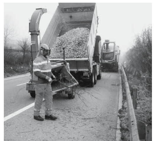
Fig. 6: tra i dispositivi di protezione individuale non devono mancare il casco di sicurezza, i protettori per occhi e udito, calzature solide, indumenti ad alta visibilità e guanti idonei con polsino di chiusura.
