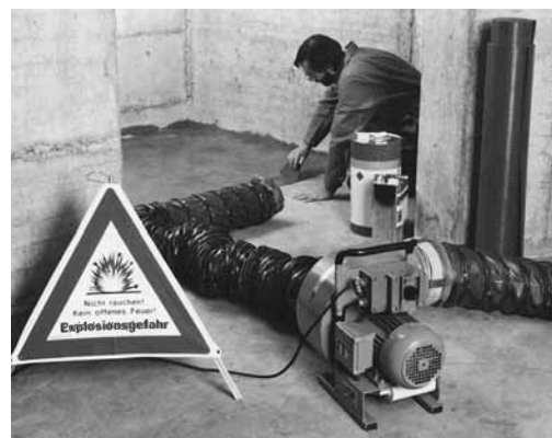
Figura 5: nelle cantine è indispensabile un'aspirazione artificiale. Se necessario, occorre usare ventilatori portatili.
