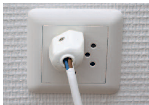
Fig. 22: Sostituire prontamente i cavi elettrici difettosi.
