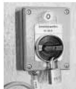
Figura 2: interruttore di sicurezza che riporta chiaramente l'indicazione della parte d'impianto a cui si riferisce.
