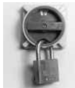
Figura 1: interruttore di sicurezza bloccato con un lucchetto personale.
