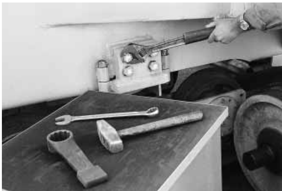
Figura 30 Questi attrezzi sono inadeguati per un serraggio controllato dei bulloni.
