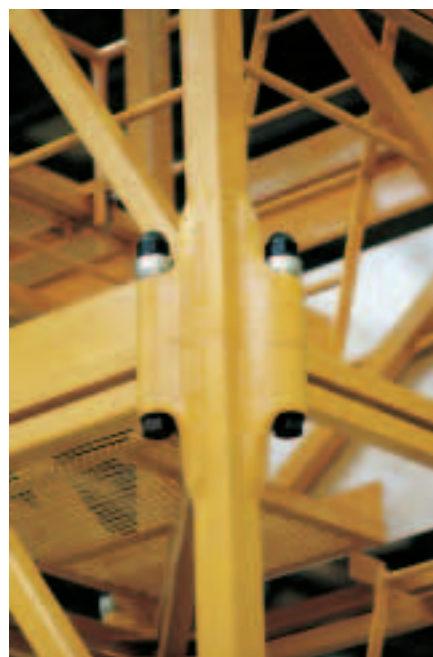
Figura 3 Collegamenti bullonati ad alta sollecitazione alla torre di una gru.
