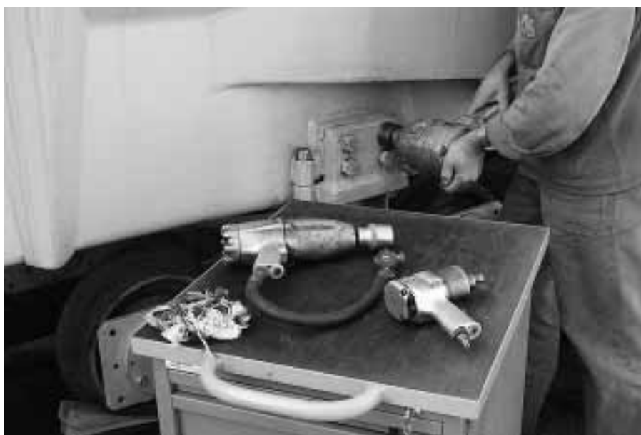
Figura 31 Le avvitatrici a percussione non sono adatte per un serraggio controllato dei bulloni.
