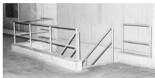
Figura 1: accesso alla scala delimitato da parapetti. La tavola fermapiedi di costruzione robusta evita danni in caso di urti di veicoli.
