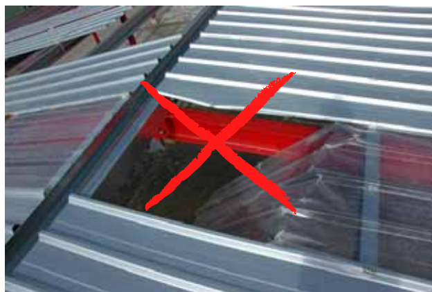
3 Le cadute in seguito a sfondamento di un lucernario devono essere evitate.
