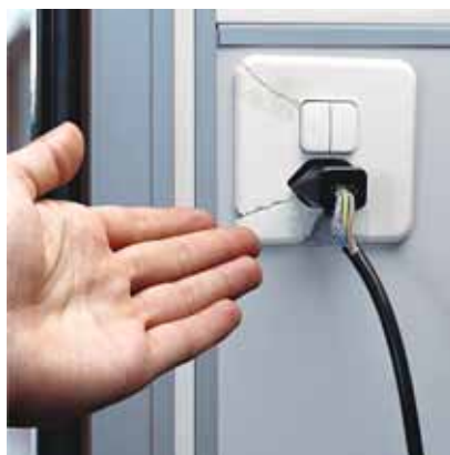
Fig. 2: copertura difettosa, rischio di elettrocuzione
